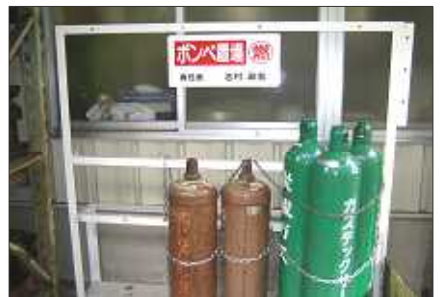
ポンベ置場の安全対策
